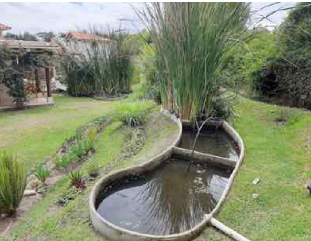
Tanque sedimentador de canal de riego
