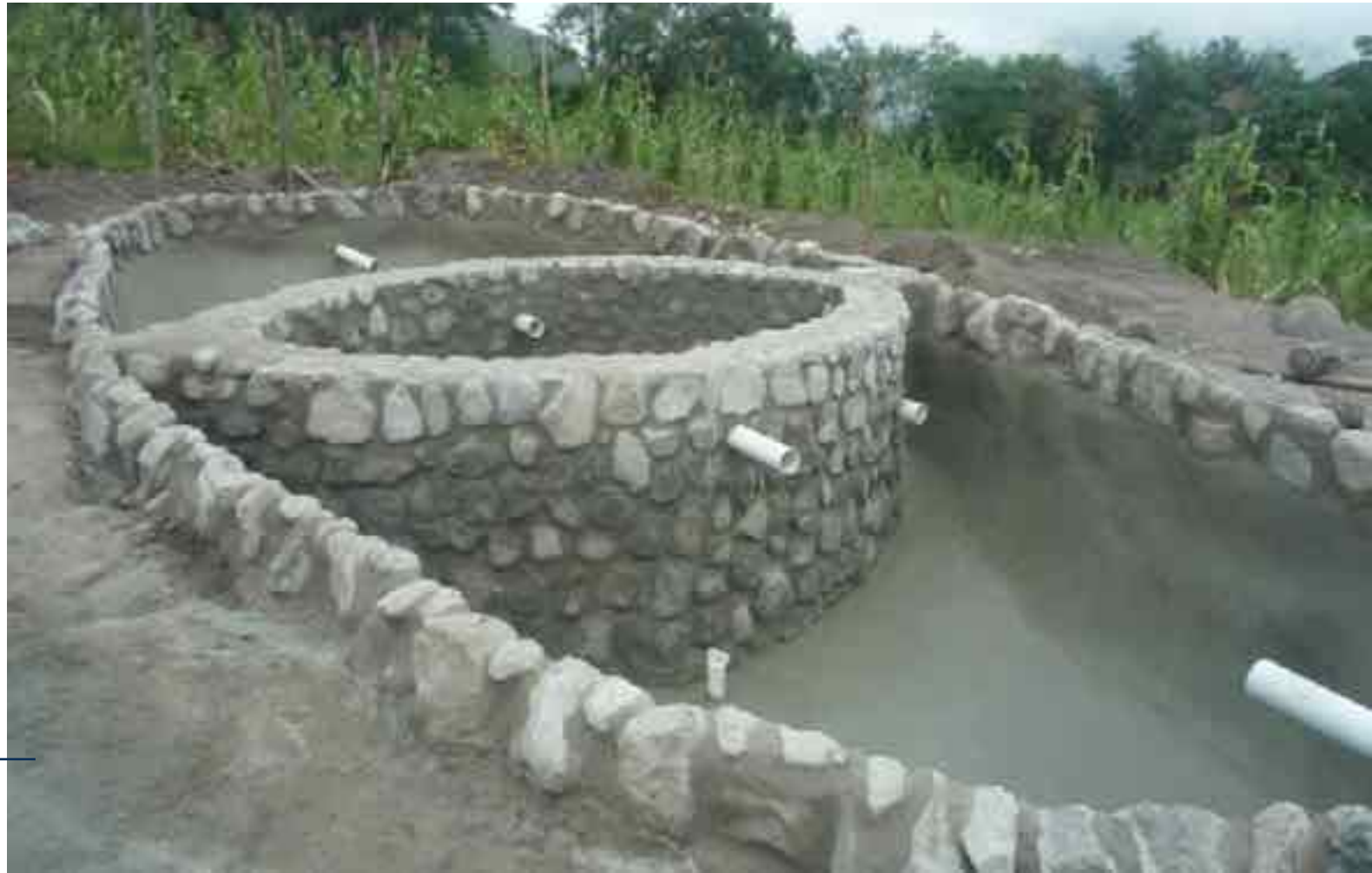
Ferro cemento para pantano construido de flujo horizontal
